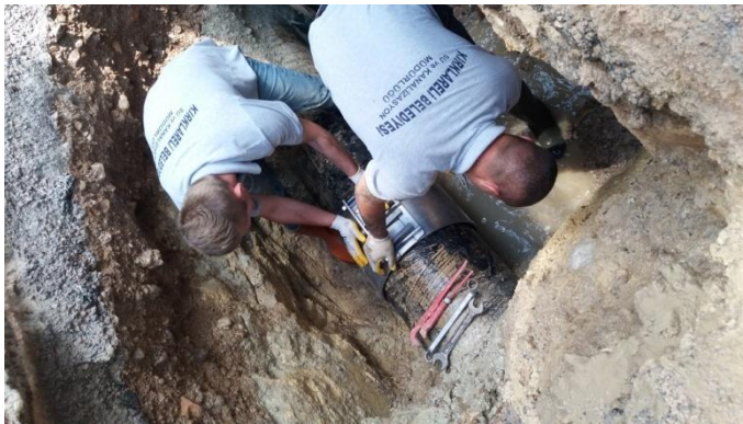
Resim 7 Ana Boru Arızası
